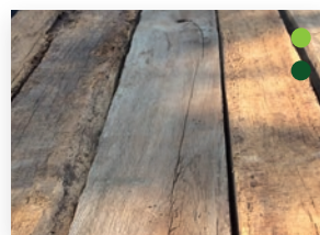
Vieilles planches de lambris en chêne, exposées au soleil, à la pluie et au vent
