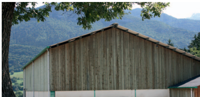
Fig. 24 Bardage dont le bois a été traité en autoclave au moyen de produits contenant des sels métalliques.
